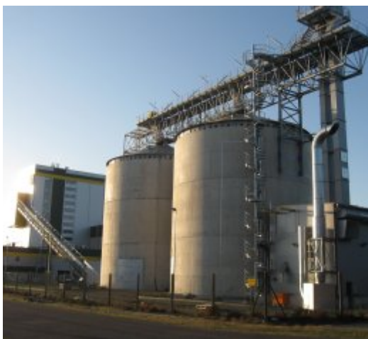
Manutention développée par Scaldis, photo Cofely
